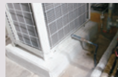
▲秦食品様でのドレン配管状況
