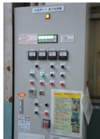
▲ハイブリッド式システムを管理する 集中管理用制御盤。高効率な運転を 実現。
