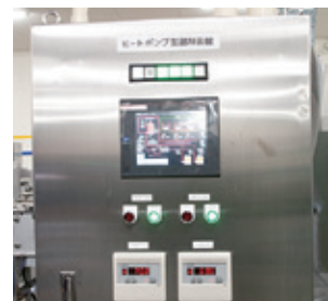
▲ヒートポンプ給湯機の加温制御盤。三菱電機のGOTで運転状況を表示
