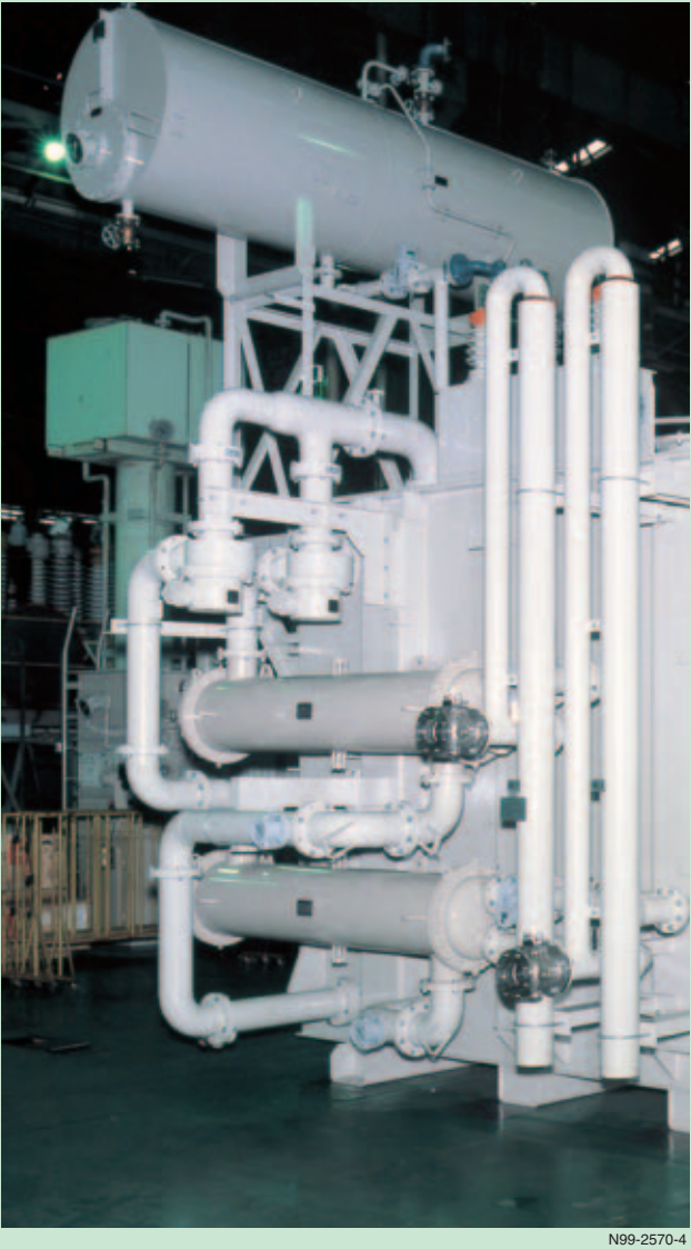
写真 3 水冷式冷却器外観
