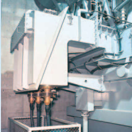
写真 10 油入エレファント形ブッシング
