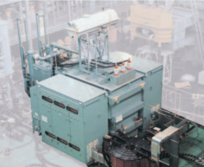
写真 2 直流製鋼アーク炉用変圧器
