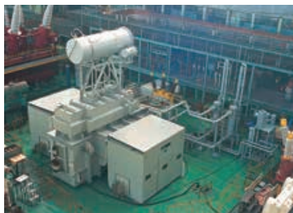
▲電解用大容量直流電源装置(S-Former) 入力：三相、69kV、60Hz 出力：DC 407V、147,000A
