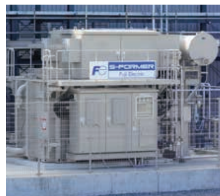
▲電解用直流電源 入力：三相, 6.6kV, 50Hz 出力：DC 80V, 60,000A
