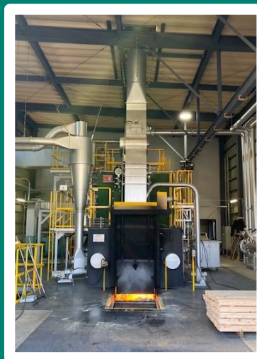
バイオマスボイラー
