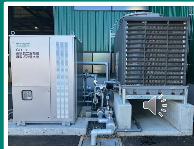
吸収式冷温水機
