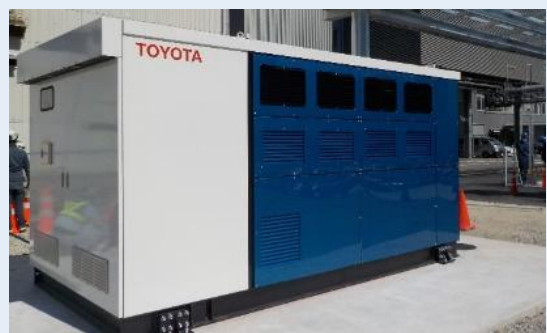
燃料電池自家発電 (本社)
